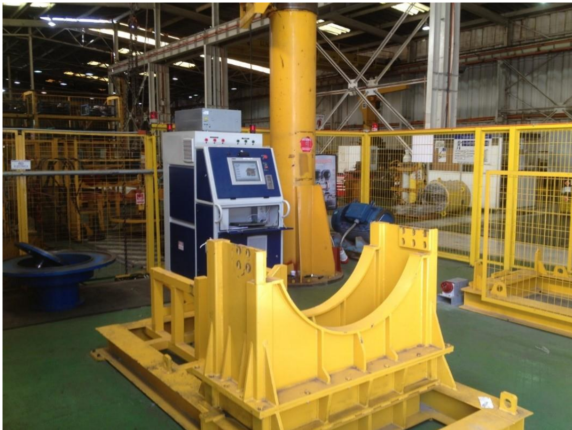
Figura 50 Banco de Pruebas de Motores de Tracción
