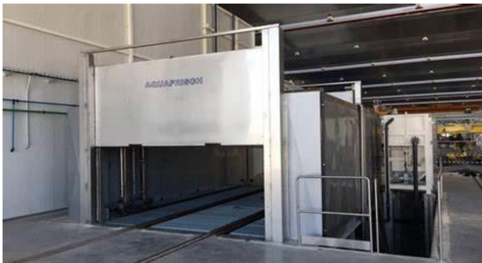
Figura 64 Cabina de lavado de Bogíes
