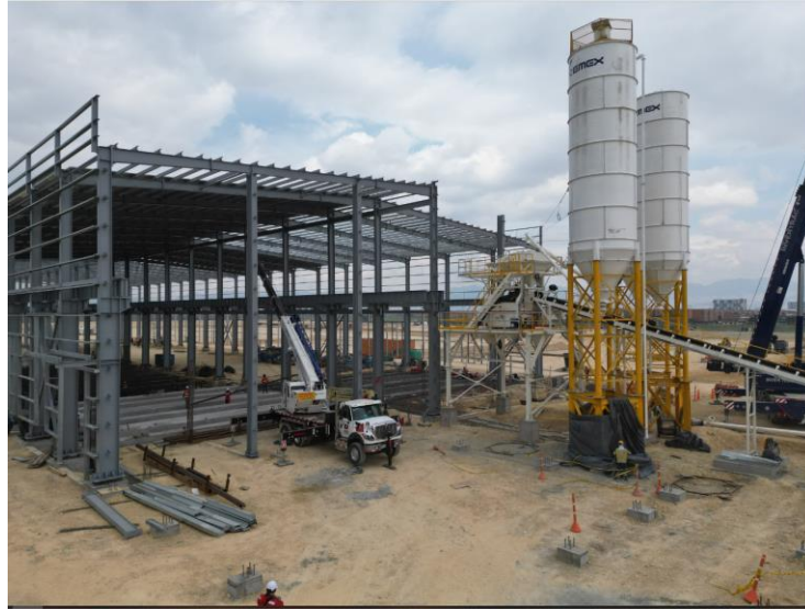
Con una planta de concreto propia, en el área de prefabricados será el lugar de producción de los pilotes PHC. Esta planta tendrá un rendimiento estimado de 1.000 metros lineales de producción en turnos de 10 de horas.
