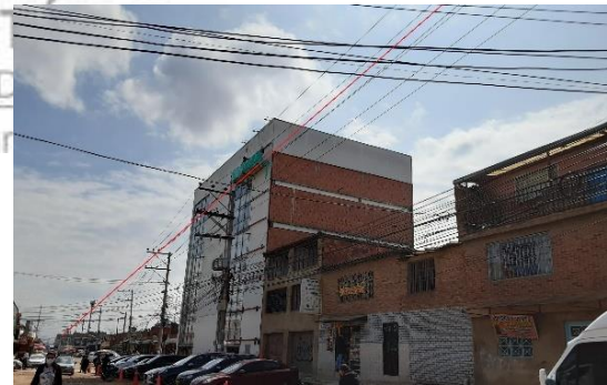
Figura 9. Doble red de MT, red de BT, y redes de comunicaciones en poste
