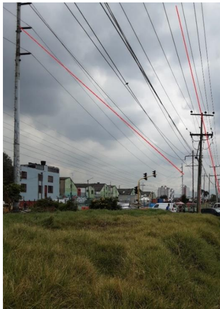
Figura 12. Redes de MT paralelas al recorrido de la vía férrea.
