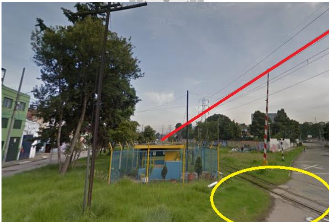
Figura 15. Redes de baja, media y alta tensión, como también redes de comunicaciones en la vía férrea.
