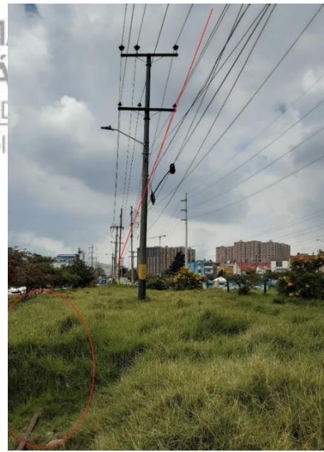
Figura 13. Redes de MT paralelas al recorrido de la vía férrea.
