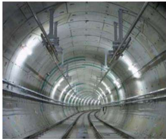
Figura 1. 1500V con catenaria rígida en túnel
