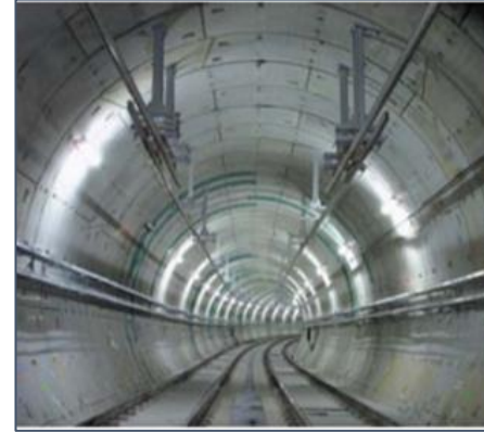
Catenaria rígida en túnel
