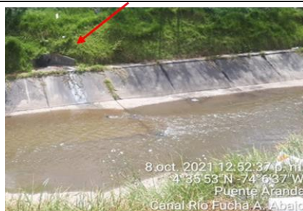
Fotografía 52 Conexiones erradas sobre Canal Río Fucha
