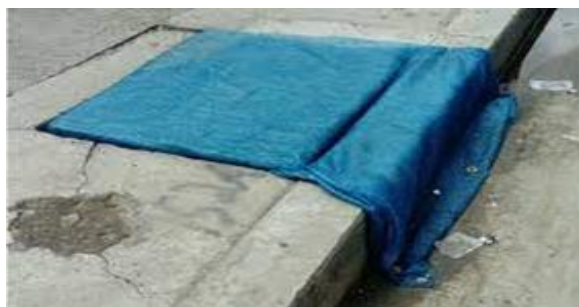
Figura 30 Protección de sumideros
