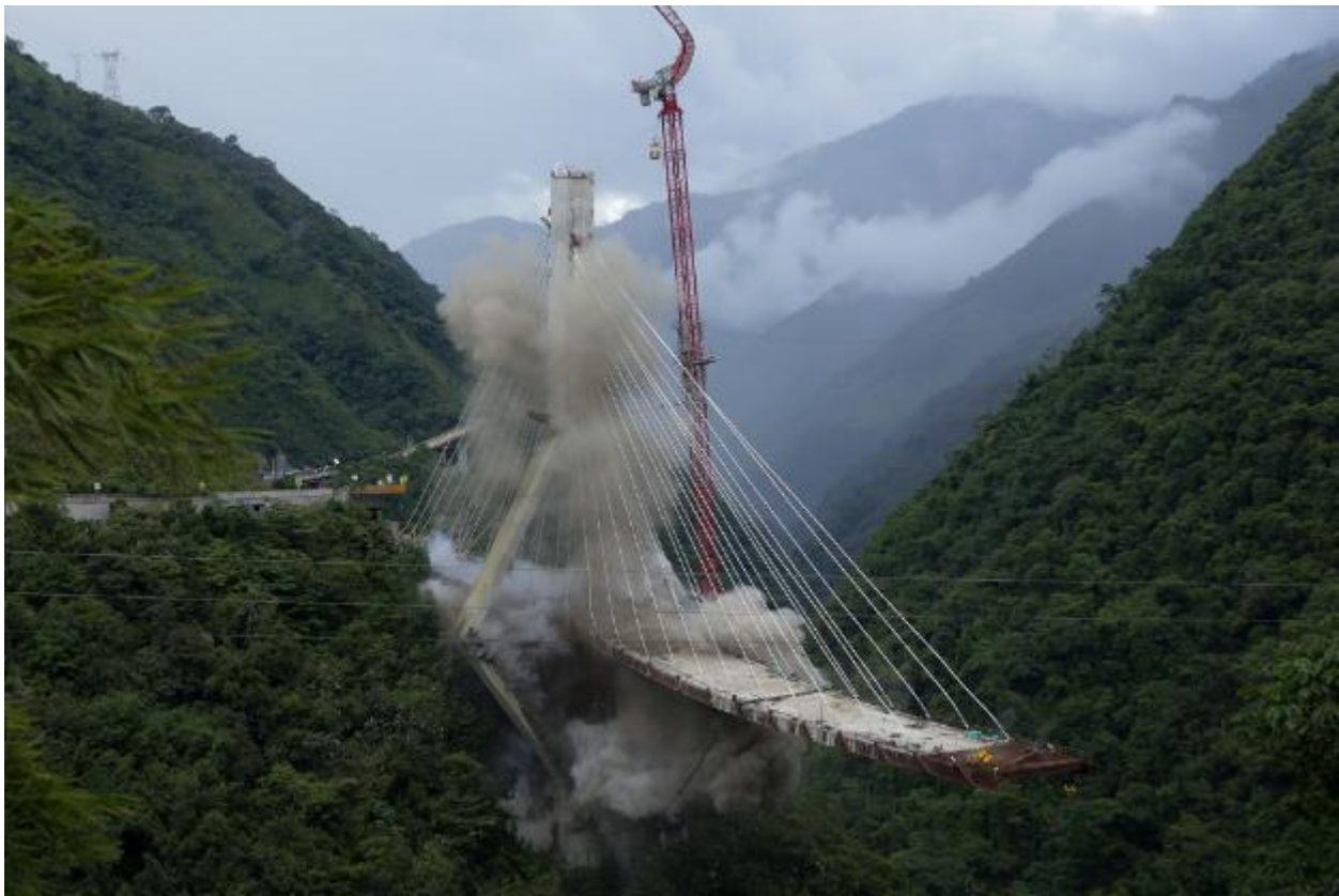
Imagen 5 Implosión puente Chirajara, Colombia
