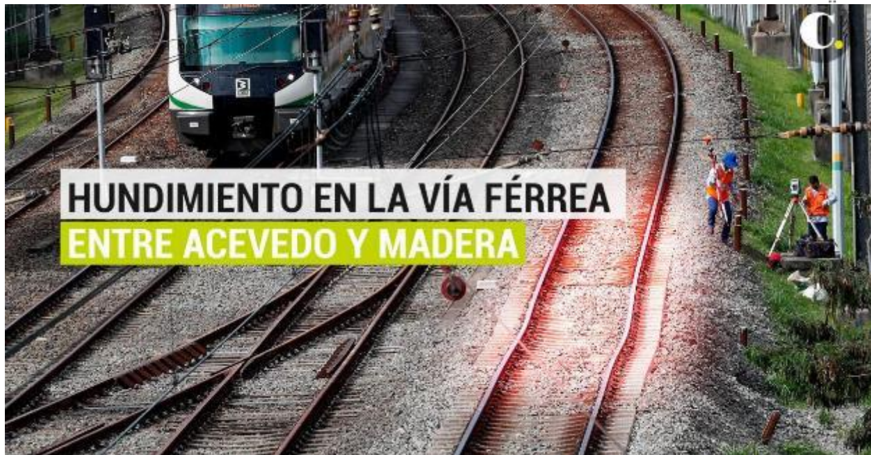
Imagen 6 Hundimiento línea férrea Medellín, Colombia
