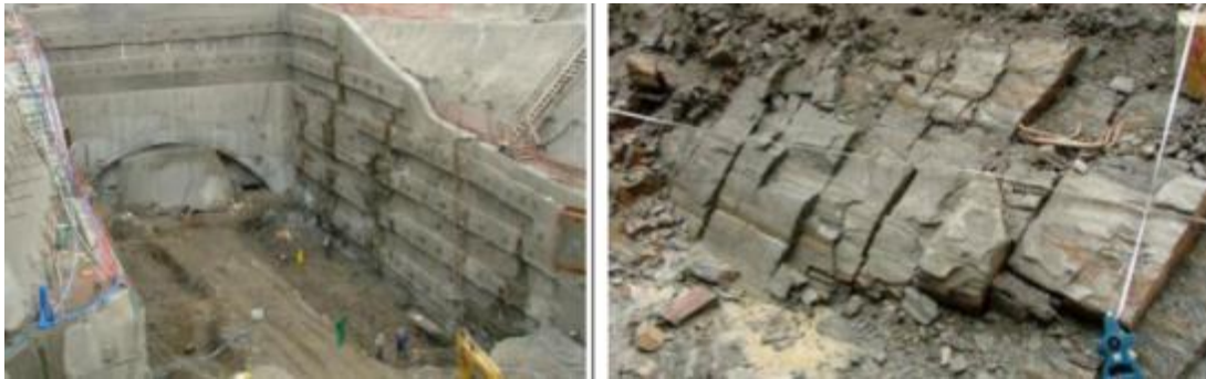
Imagen 65 Excavación posterior al siniestro
